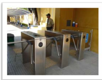
Sistema de Control de Acceso
